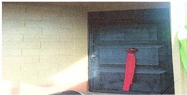
Foto 3: MANTENIMIENTO A PUERTAS POR MAL ESTADO
