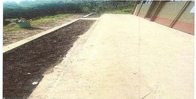
foto2: REPARACIÓN DE CUNETA EN MAL ESTADO
