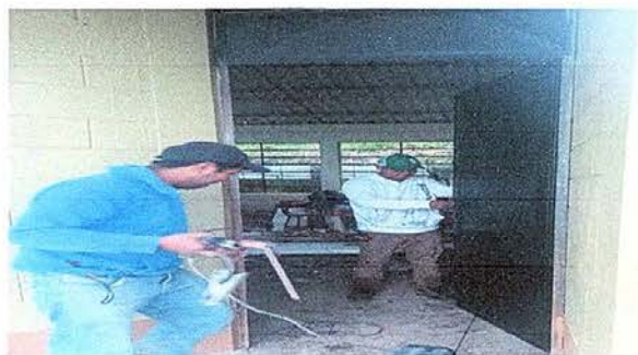
Foto 3: MANTENIMIENTO A PUERTAS POR MAL ESTADO
