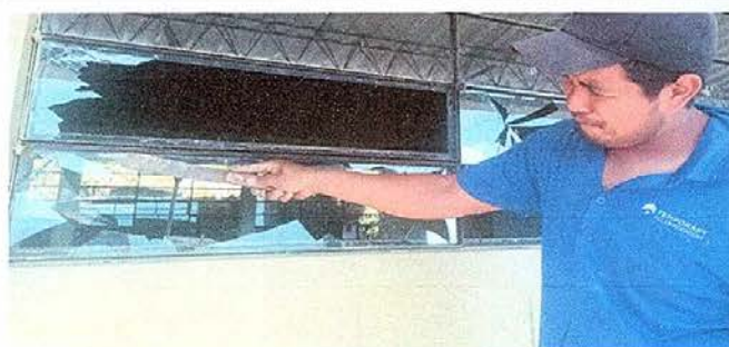
Foto 5: SUSTITUCIÓN DE VIDRIOS POR MAL ESTADO
