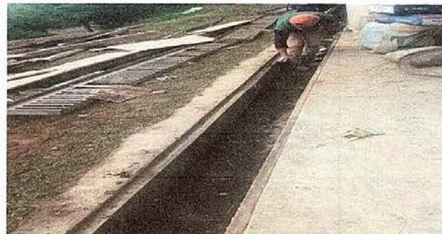
foto2: REPARACIÓN DE CUNETA EN MAL ESTADO
