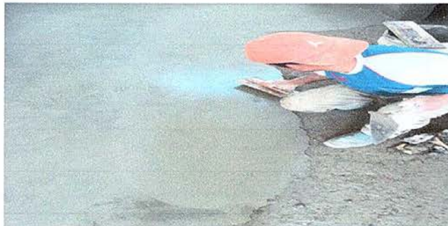
Foto 7: SUSTITUCION DE PISO POR MAL ESTADO
