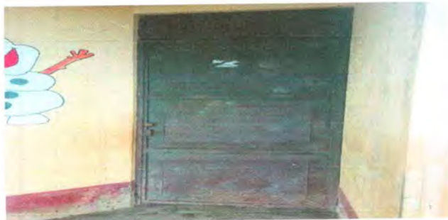
Foto 3: MANTENIMIENTO A PUERTAS POR MAL ESTADO
