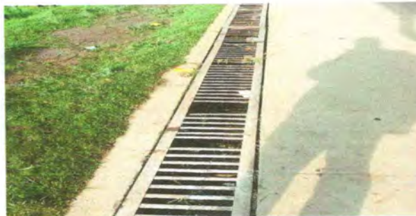
foto2: REPARACIÓN DE CUNETA EN MAL ESTADO
