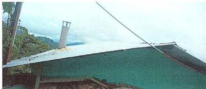
Foto No. 13: Sustitución de techo de lámina de cocina en malas condiciones
