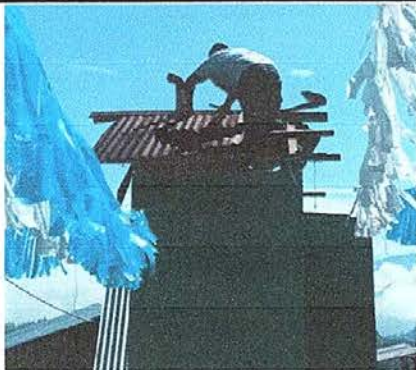
Foto No. 1: Sustitución de lámina de sanitarios en malas condiciones.
