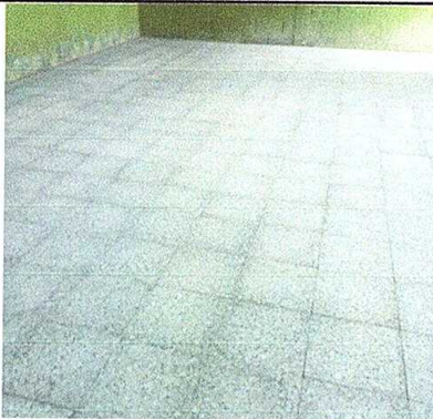
Foto 3: piso concreto en malas condiciones
