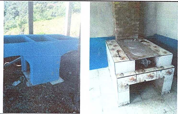
Foto 4: pila y plancha en malas condiciones
