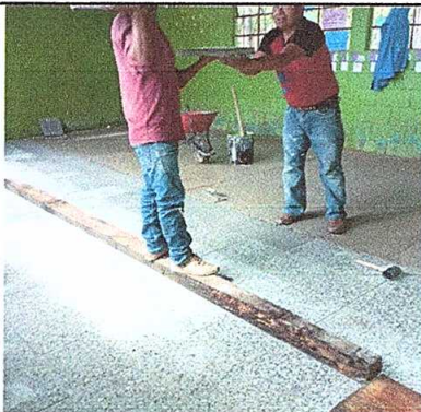
Foto 3: piso concreto en malas condiciones
