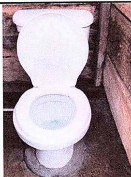
Foto No. 5: Sustrucción de inodoro.
