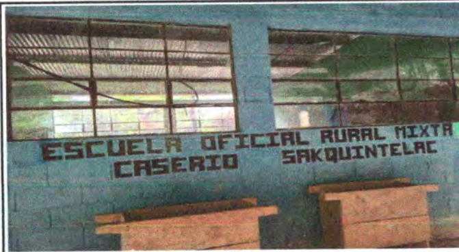
Foto 4: Ventanas aula 2 en malas condiciones necesitan sustitución
