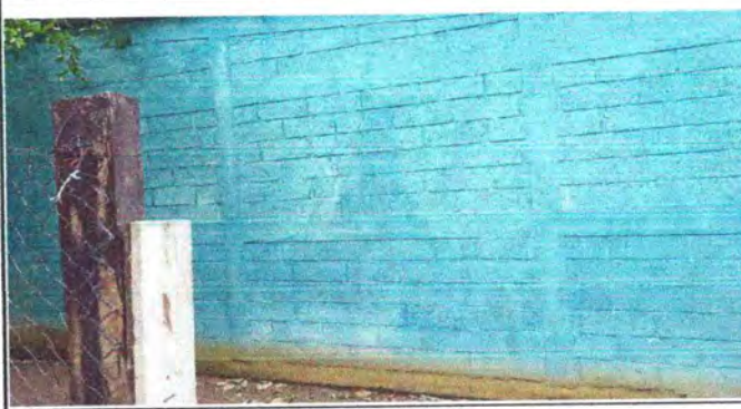
Foto 10: Muros exteriores requieren aplicación de pintura
