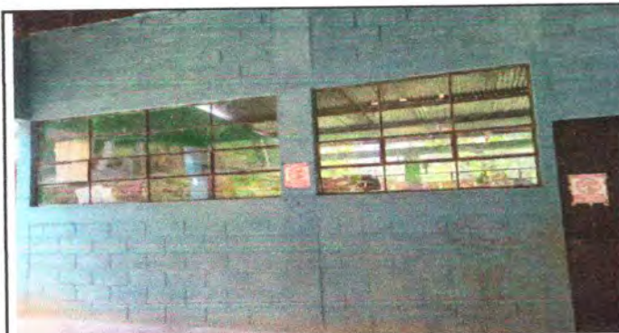
Foto 3: Ventanas aula 1 en malas condiciones necesitan sustitución
