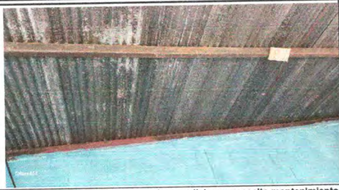
Foto7: Estructura del techo en malas condiciones necesita mantenimiento
