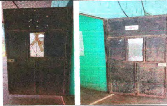
Foto 2: puertas de las aulas en malas condiciones
