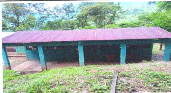
Foto 8: Techo de lámina de la escuela necesita sustitución
