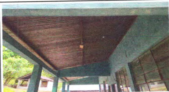
Foto 9: Techo de lámina de la escuela necesita sustitución
