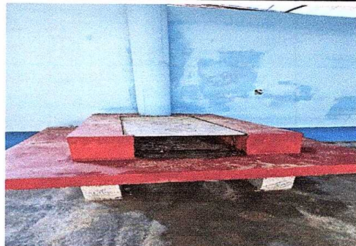
Foto 4: Plancha de la cocina
