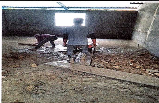
Foto 5: Piso de la cocina
