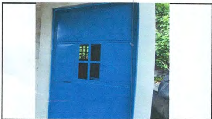
Foto 3: Sustrucción de puerta
