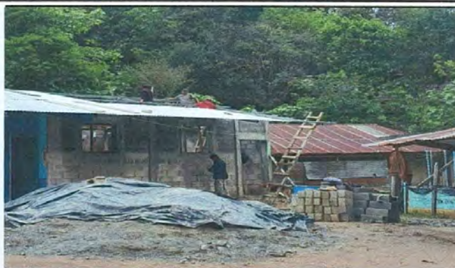
Foto 2: Sustrucción de techo
