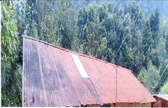
Foto 1: Láminas en malas condiciones
