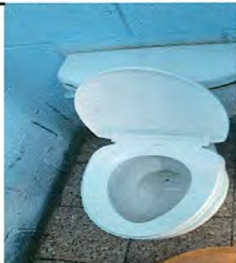
Foto 7. Tazas para baño instalados en el espacio respectivo.
