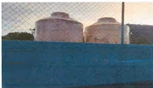
FOTO No. 9 ya se cuenrta con tinaco para deposito de agua
