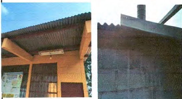
FOTO No. 3: los canales estan en mal estado
