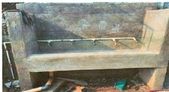
FOTO No. 6: los llaves de chorro estan en mal estado
