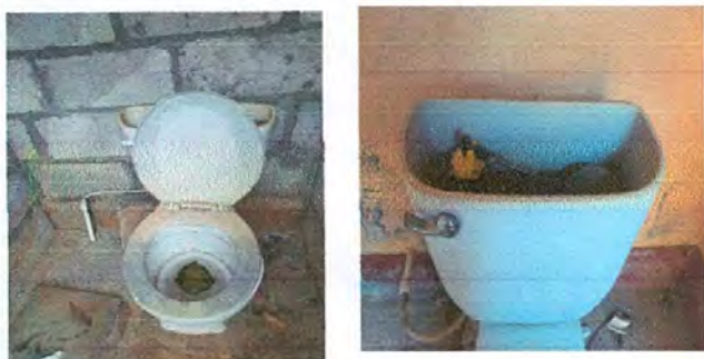
FOTO No. 5: los inodoros estan en mal estado
