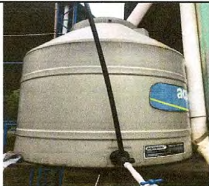
Foto 7: Depósito de agua deteriorado
