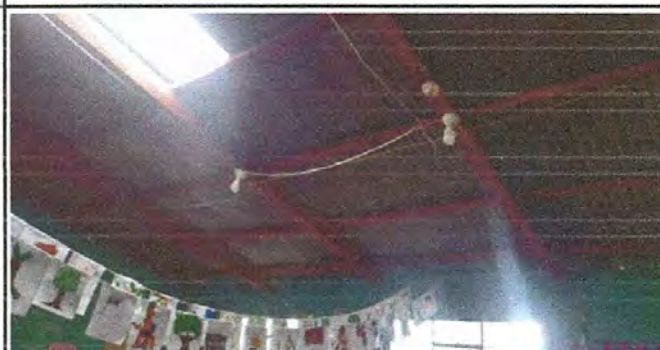
foto 10. Focos led instalados
