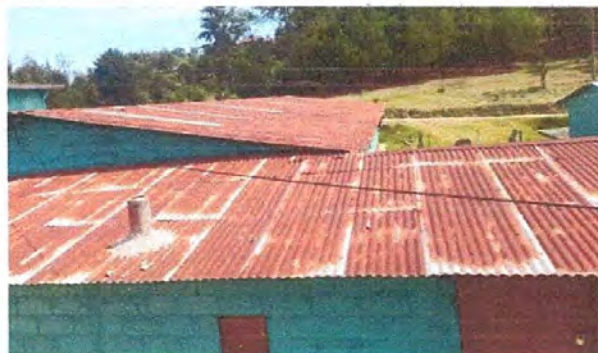
foto 2. lámina en malas condiciones
