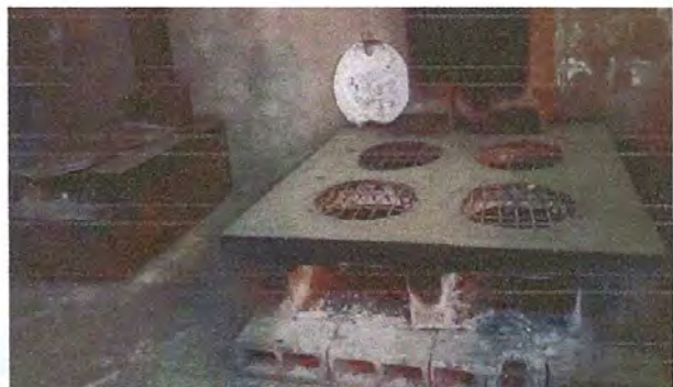
foto 1. planchas en malas condiciones
