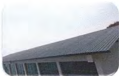
Foto 1. Pintada del techo de la escuela
