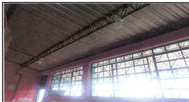
Foto 5: Instalación eléctrica terminada.
