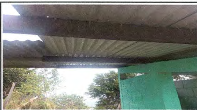
Foto 2: Estructura de metal portante de techo de baños en mal estado, oxidado.
