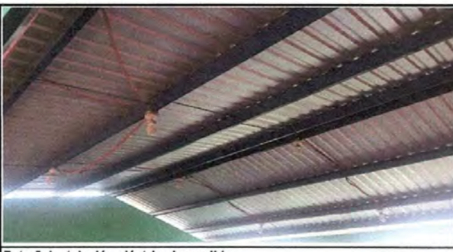
Foto 5: Instalación eléctrica inservible.
