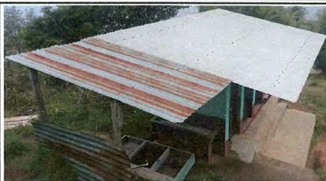
Foto 1: Lámina de techo de baños en mal estado, oxidado y con agujeros.
