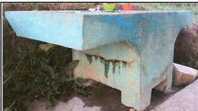
Foto 4: Insuficiente estructura para almacenamiento de agua.
