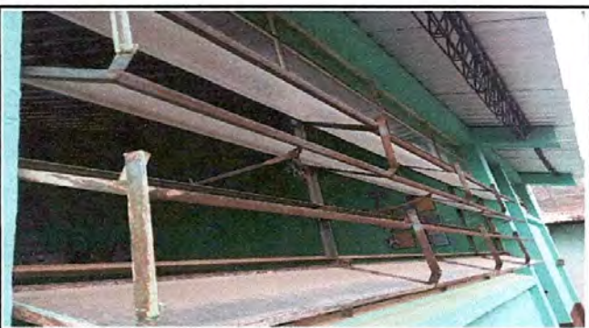
Foto 3: Estructura de ventanas de metal en mal estado, oxidado y quebrado.
