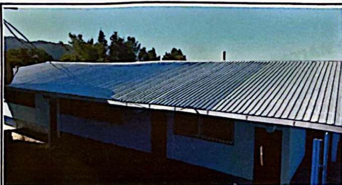
Foto 3: Techo con filtración, corroído por la oxidación.
