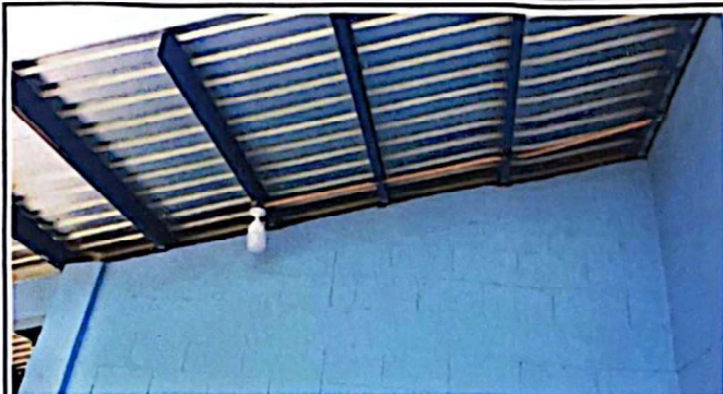
Foto 2: Sistema eléctrico inservible, lámparas fundidas
