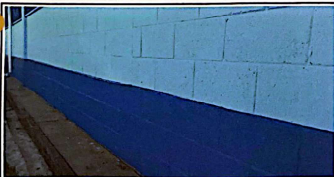
Foto 5: Paredes descoloridas afectadas por la corrosión.
