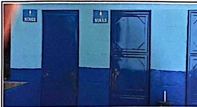
Foto 6: Puertas deterioradas por el óxido y desprendimiento de pintura.
