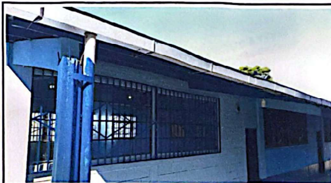
Foto 4: Canales de agua colapsados por el óxido.
