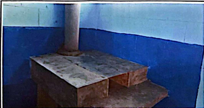
Foto 1: Plancha en mal estado
