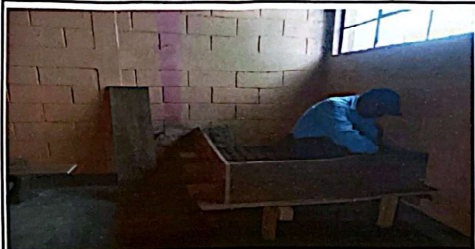
Foto 1: Plancha en mal estado
