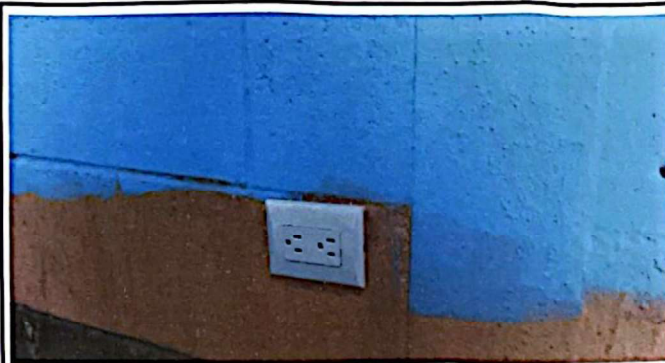
Foto 2: Sistema electrico inservible
