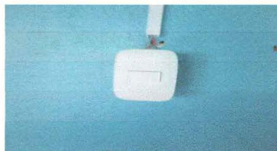
FOTO 11: Sustrucción de apagadores
