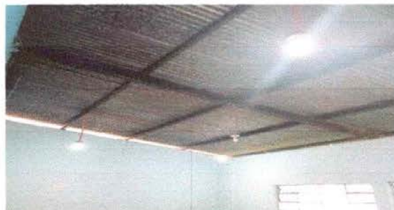
FOTO 13: Sustrucción de plafoneras
