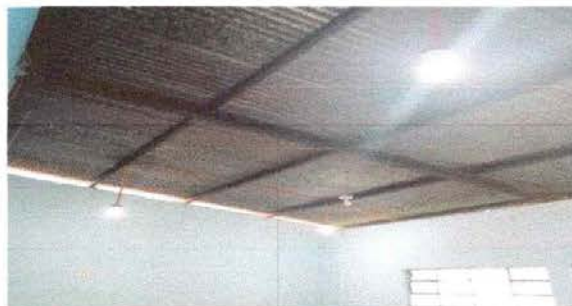
FOTO 14: Sustrucción de focos de 40 wats
