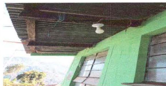
FOTO 15: Sustrucción de focos de 20 wats
