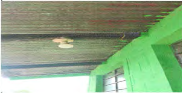
FOTO 18: Sustrucción de focos
