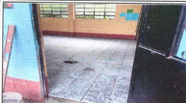
Foto 1: Sustrucción de piso de granito
