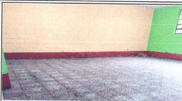
Foto 2: Sustrucción de piso de granito
