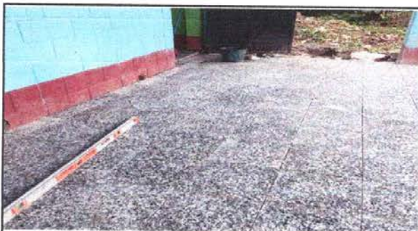
Foto 3: Sustrucción de piso de granito
