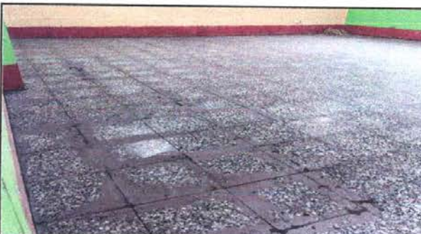
Foto 4: Sustrucción de piso de granito
