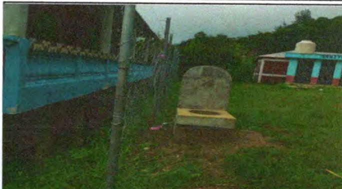
Foto 8: CAMBIAR POR MURO PERIMETRAL
