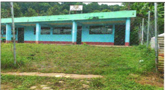
Foto 9: CAMBIAR POR PORTON DE METAL
