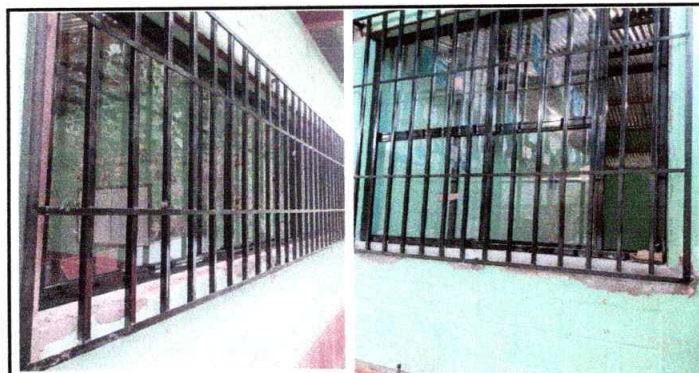
Foto 3: Sustrucción de estructura de metal de ventana
