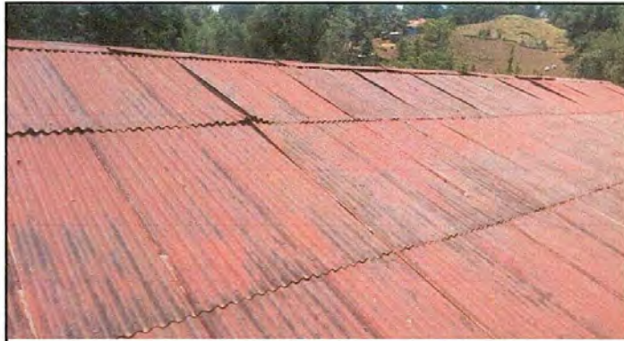
Foto 1: lámina en malas condiciones
