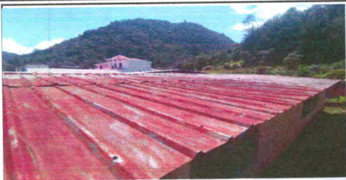
Foto 1: lámina en malas condiciones
