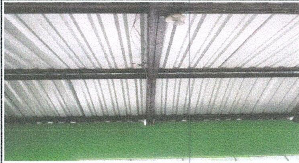
Foto 1: Laminas en malas condiciones y muchos agujeros
