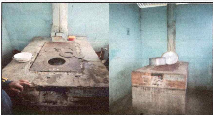
Foto1: Plancha y chimenea en malas condiciones y en deterioro
