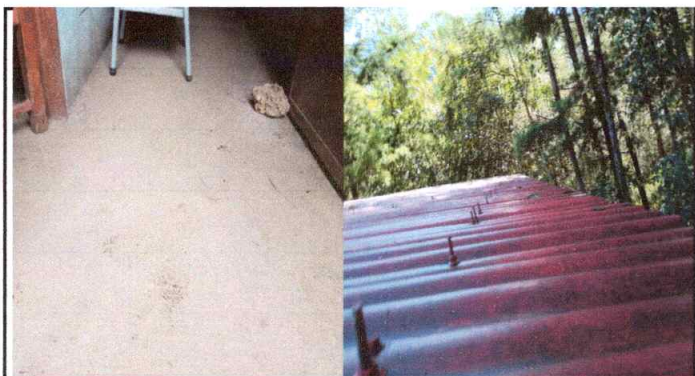
Foto 3: Piso de torta en malas condiciones en la cocina y laminas en estado oxidadas con algunas goteras.
