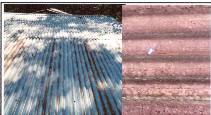
Foto 4: Laminas ya oxidadas de las aulas y algunos con agujeros,
