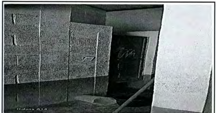
Foto 3.1 : Sustitución de puertas del baños, porque ya se encuentra en mal estado.
