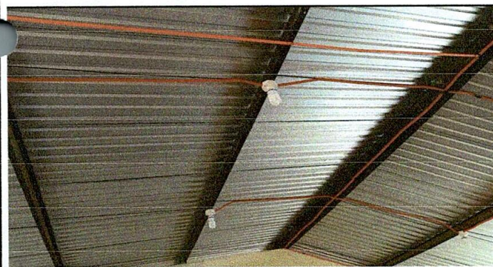
Foco 5: Sustitución de cable solido
