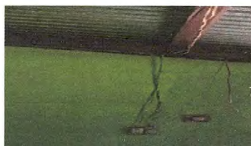
Foto 6: Cableado eléctrico en mal estado.
