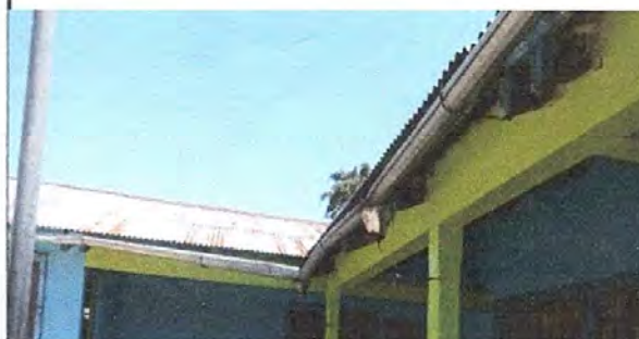
Foto 4: Canales en mal estado.
