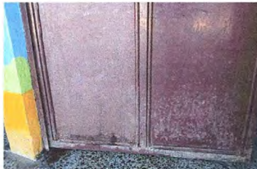
Foto 2: Deterioro de puertas.
