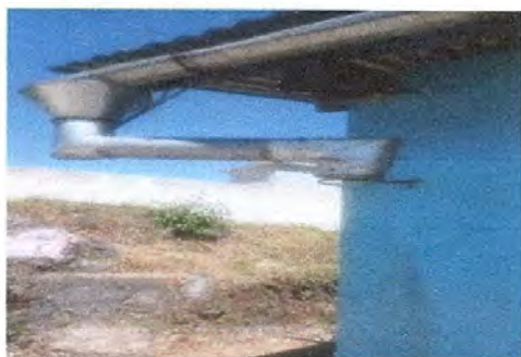
Foto 5: Bajadas de agua pluvial ya deteriorada.
