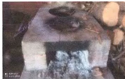
Foto 10: Estufa artesanal en mal estado
