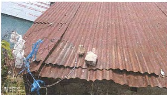
Foto 1: Deterioro de las láminas
