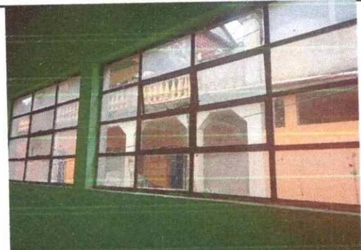
Foto 4: Vidrios de las ventanas
