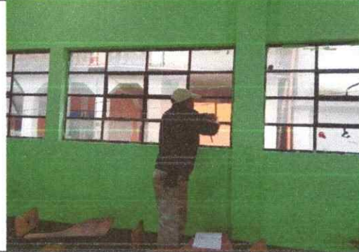
Foto 4: Vidrios de las ventanas
