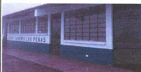
Pintura en mal estado
