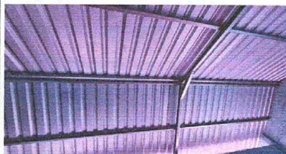
Foto 2: Deterioro de soporte de techo
