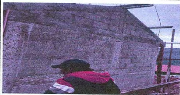
Foto 1: Paredes en mal estado
