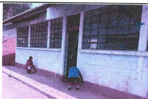
Pintura en mal estado
