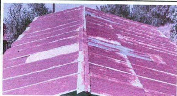
Foto 3: Techo en mal estado
