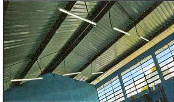
Foto 4: Nuevas iluminaciones de energia electricidad
