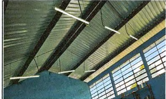
Foto 4: Nuevas iluminaciones de energía electricidad
