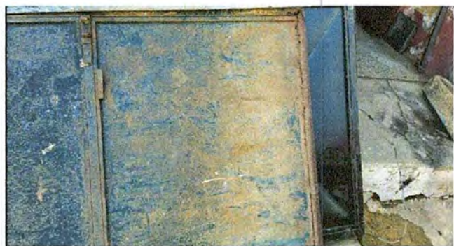
Foto 5: Cambio de puertas de malas condiciones
