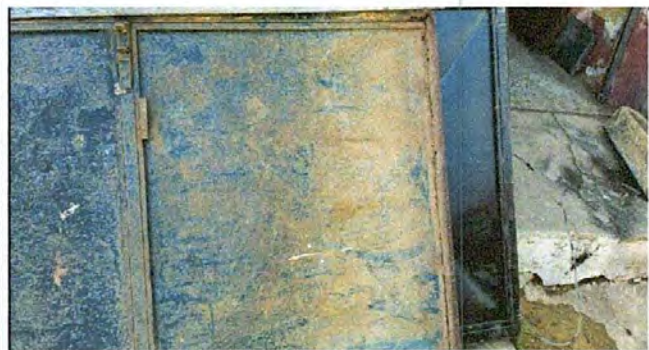
Foto 5: Cambio de puertas de malas condiciones
