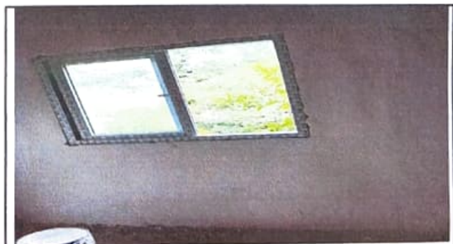
Situación de ventanas en mal estado
