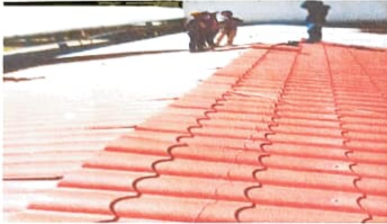
Foto 1: lámina en malas condiciones
