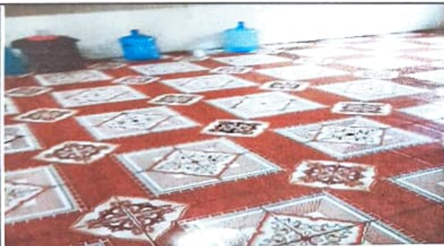
Foto 3: Situación de Piso en mal estado
