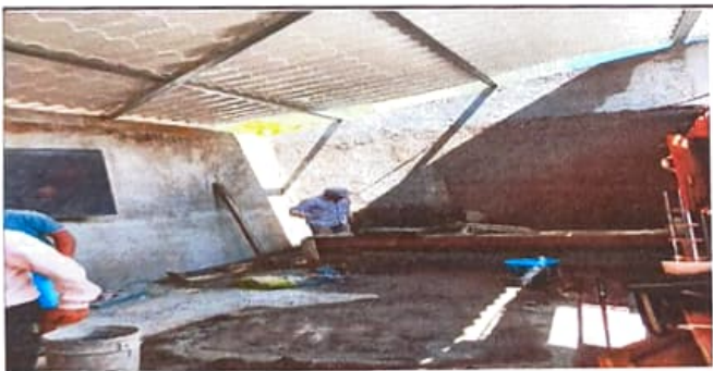
Foto 3: Situación de Piso en mal estado
