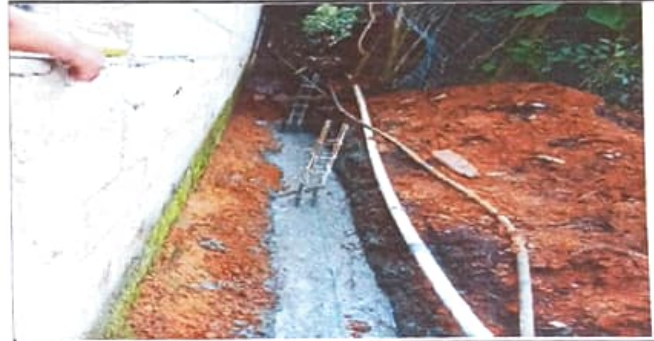
Foto: Situación de muros perimetrales en mal estado.
