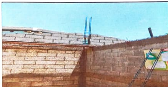
Foto 5. Situacion de repello y cernido de paredes
