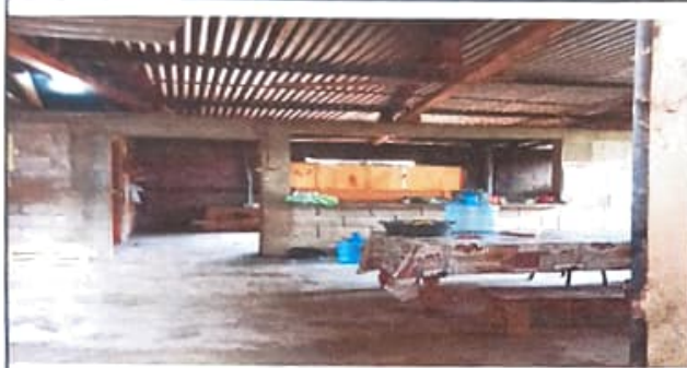
Foto 1: lámina en malas condiciones
