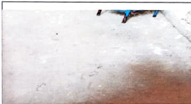
Foto 3: Situación de Piso en mal estado
