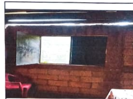
Situación de ventanas en mal estado
