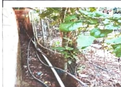
Foto: Situación de muros perimetrales en mal estado.
