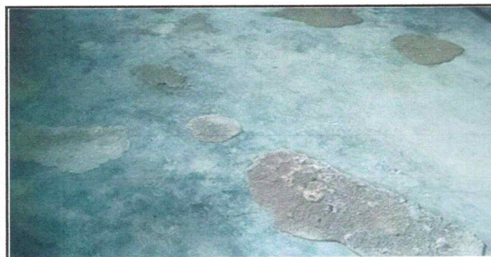
Foto 3: piso mal estado
