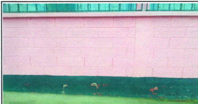
Foto 2: pintura mal estado muros exteriores e interiores
