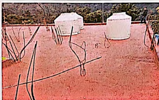
FOTO No. 8 DEPOSITOS DE AGUA
