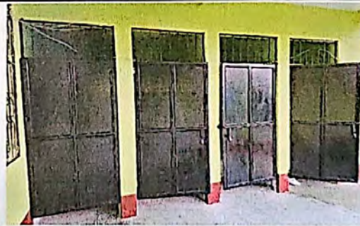
FOTO No. 6 SERVICIOS SANITARIOS
