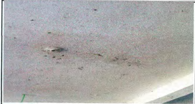
FOTO 8. INSTALACION ELECTRICA DETERIORADA Y FALTA DE FOCOS
