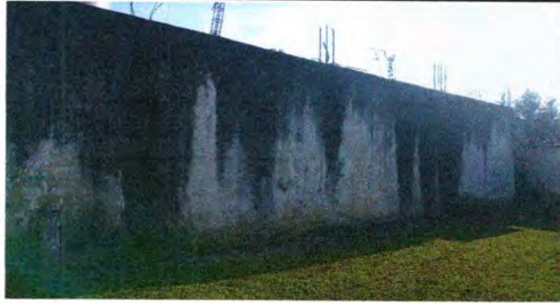
FOTO 7. PINTURA DE PARED EN MAL ESTADO
