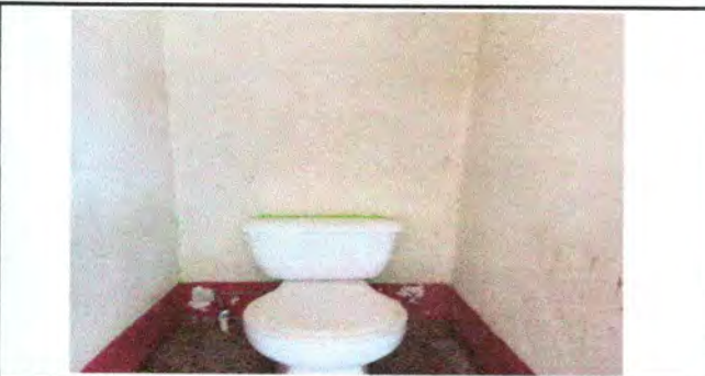
FOTO 6. TASA DE BAÑOS EN MAL ESTADO
