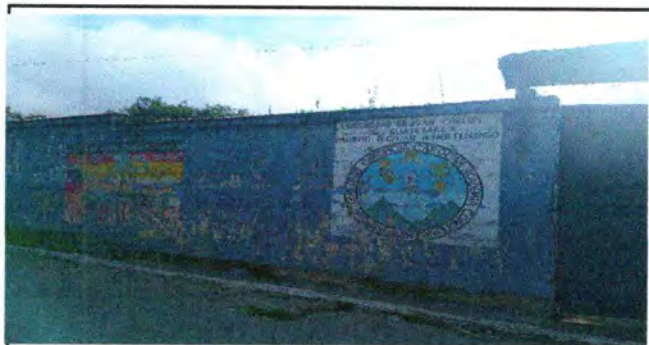
FOTO 3. PINTURA DE MURO DETERIORADO
