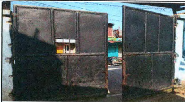
FOTO 2. PINTURA DE PUERTAS Y PORTON DETERIORADO
