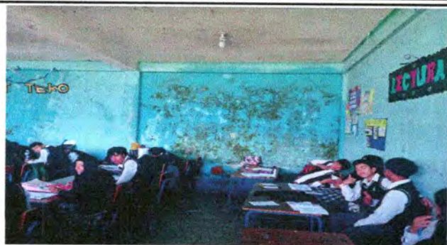
FOTO 1. PARED Y LOZA EN MAL ESTADO
